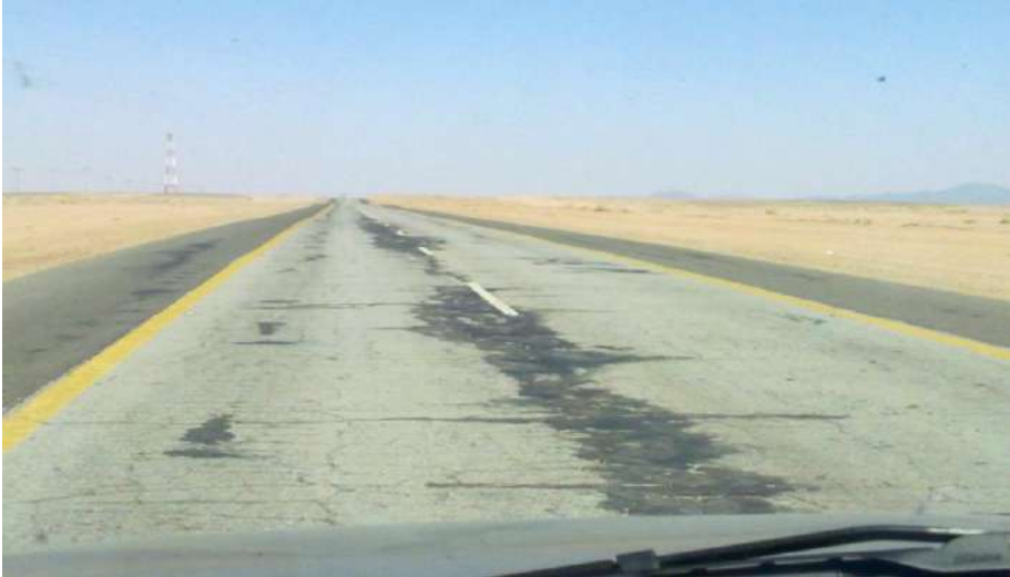
صورة (٦). تلف الطريق الوحيد الذي يربط (ضرية) بمحافظة (الرس).
